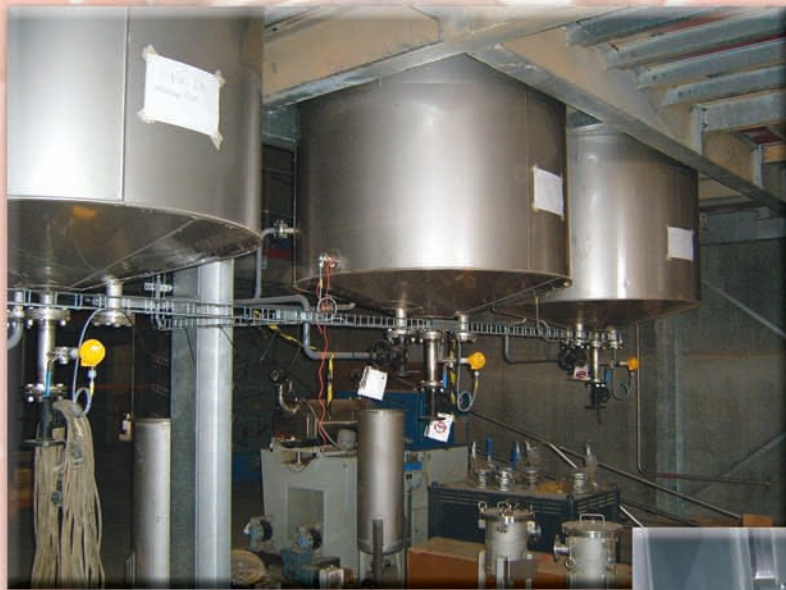
Instalaciones industriales en acero inoxidable para látex
