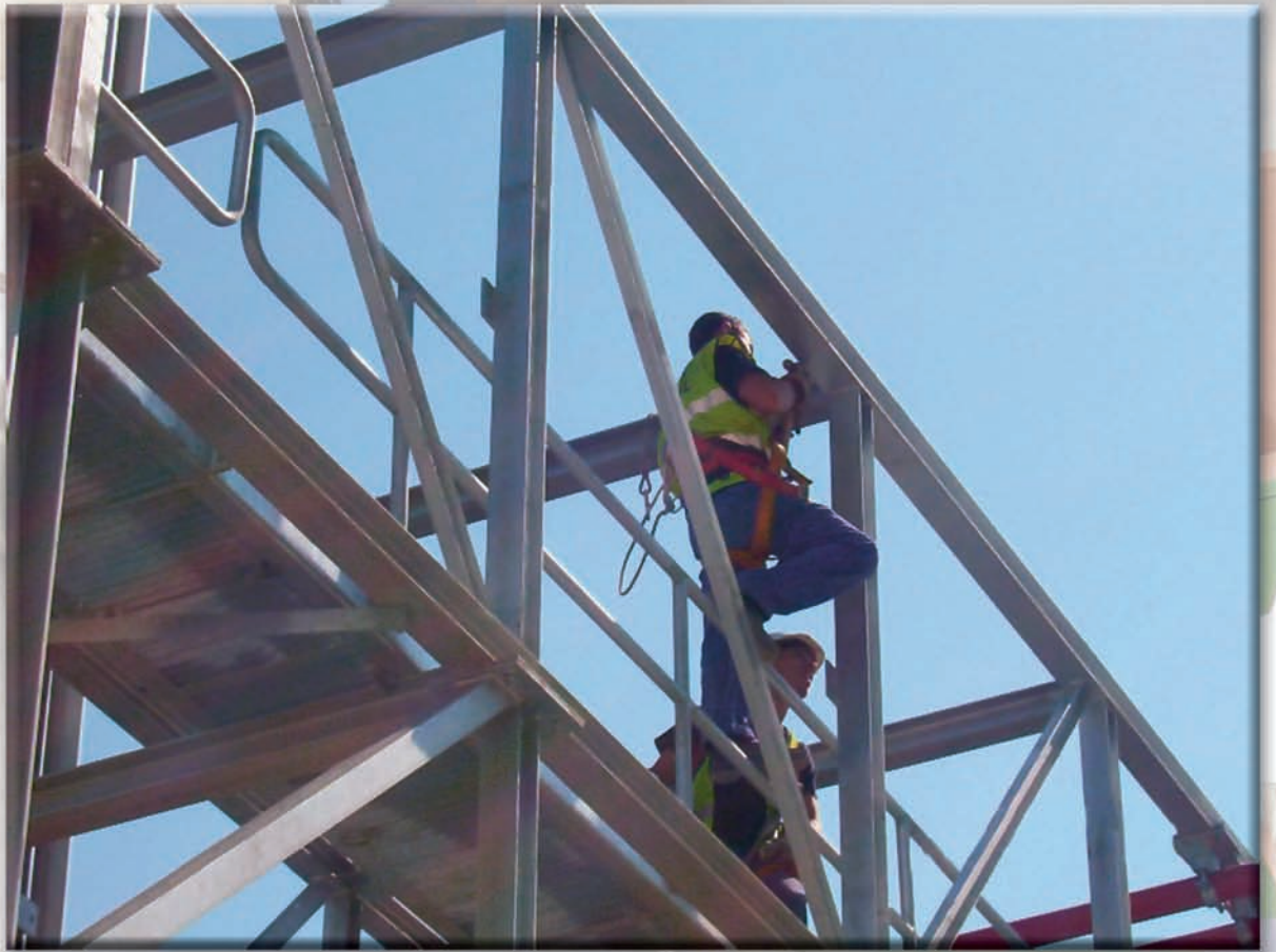
Rack de estructura galvanizada para instalación de tuberías
