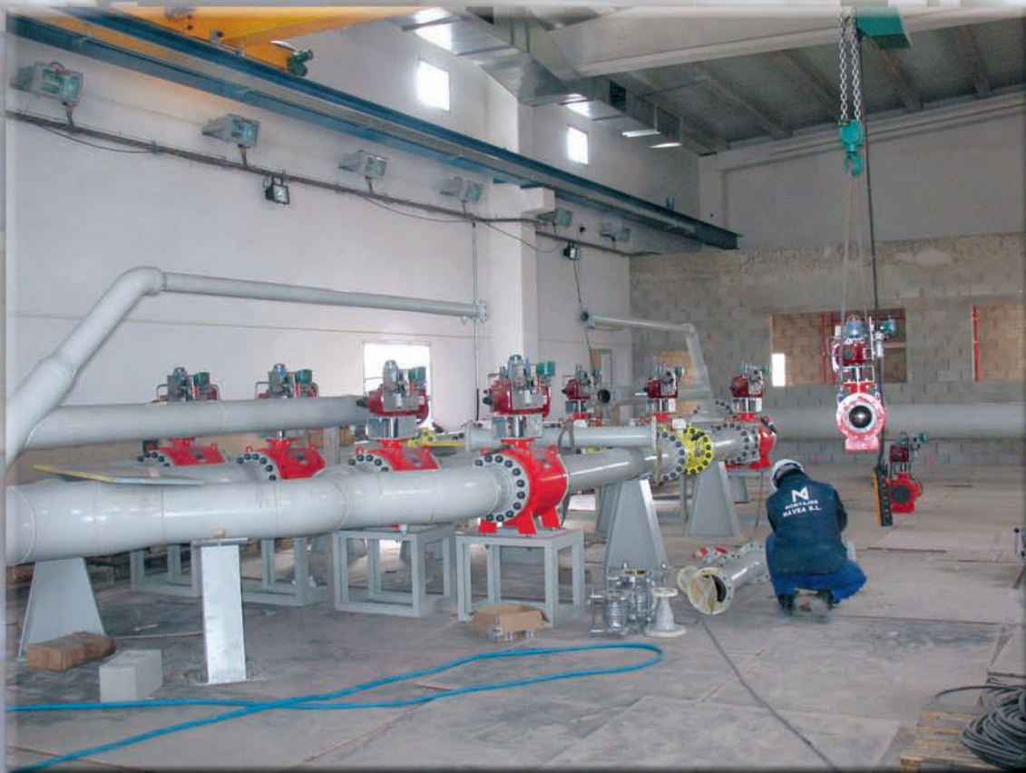
Montaje de lazo de calibración de contadores de gas
